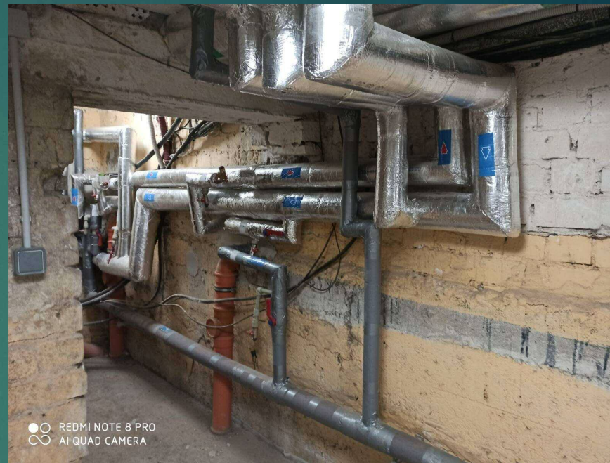
Pav. Požeminis inžinerinių tinklų kolektorius
